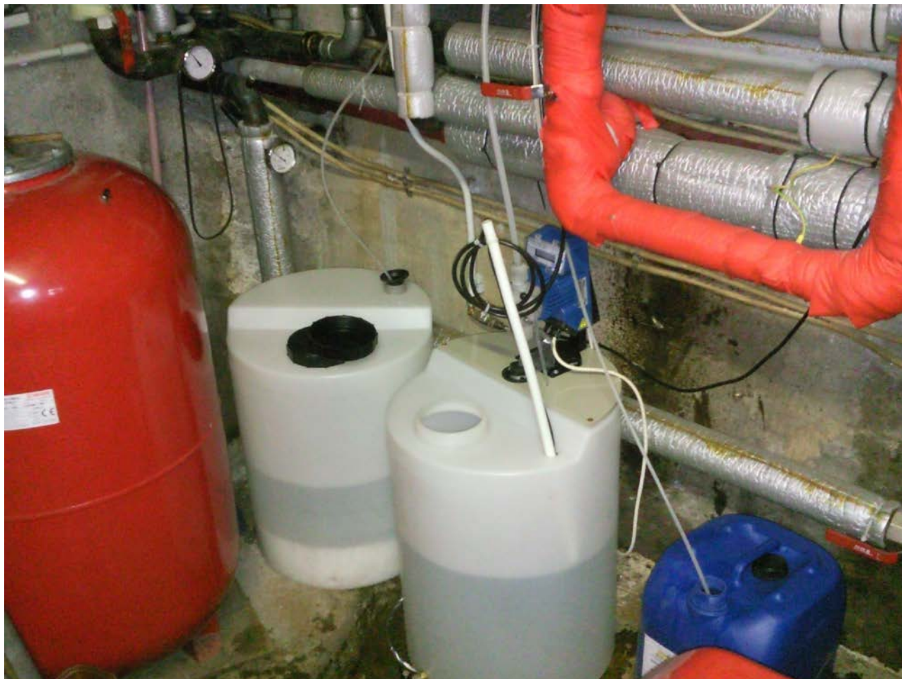
Serbatoi di salamoia e Anolyte, con pompa dosatrice
